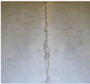
Eine beschädigte Bestandsfuge ist zu sanieren.
